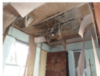
雨漏りしていなかったはずの家が、2年見ないうちに雨漏りで屋根が崩れるほどに。台風の際に隣の家に物が飛び、ご近所の方が台風の後処理をされていました。
